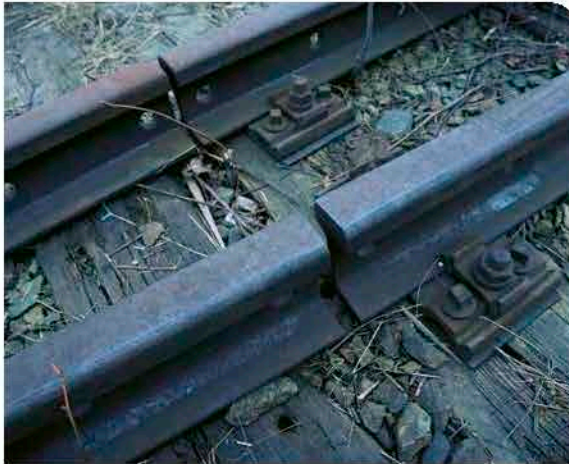
2.32 De no existir las juntas de dilatación (espacios entre las vías), los trenes podrían descarrilarse.
